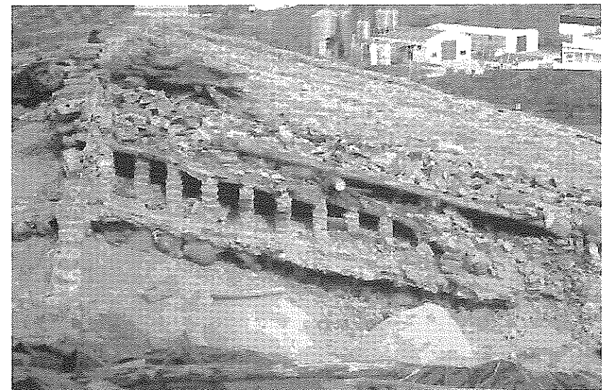
Fig. 10: Iglesia Parroquial de San Blas. Elementos de madera en reparaciones de cubierta.
