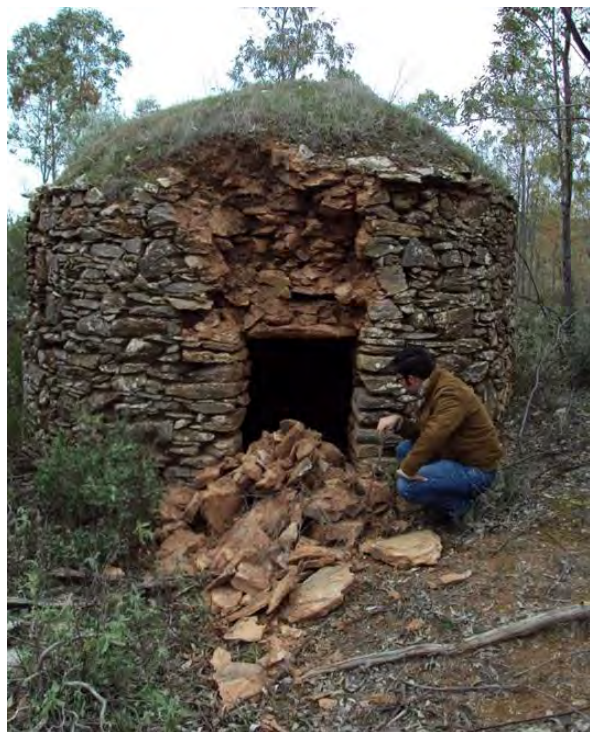
Fig. 8: Chozo íntegramente de piedra con cubierta de falsa cúpula o por aproximación de hiladas en serio proceso de deterioro.
